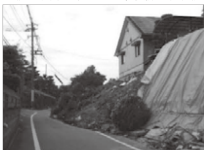
《H28 熊本地震での小規模擁壁被害》
