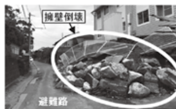
小規模造成宅地の被害
